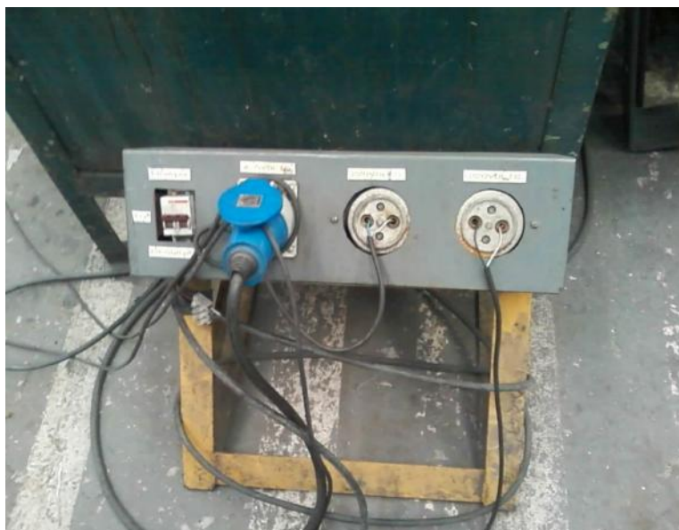
Figura 16-Instalação elétrica Fonte: Arquivo próprio
