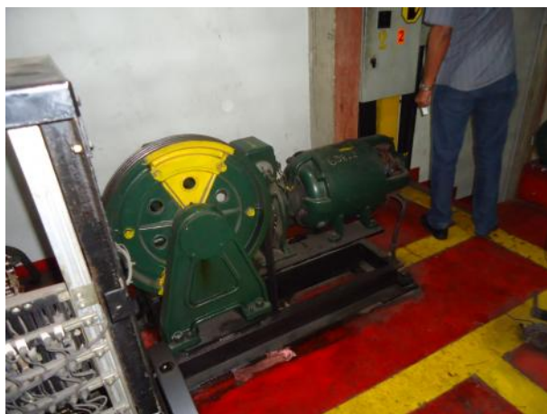
Figura 13-Manutenção em elevador
